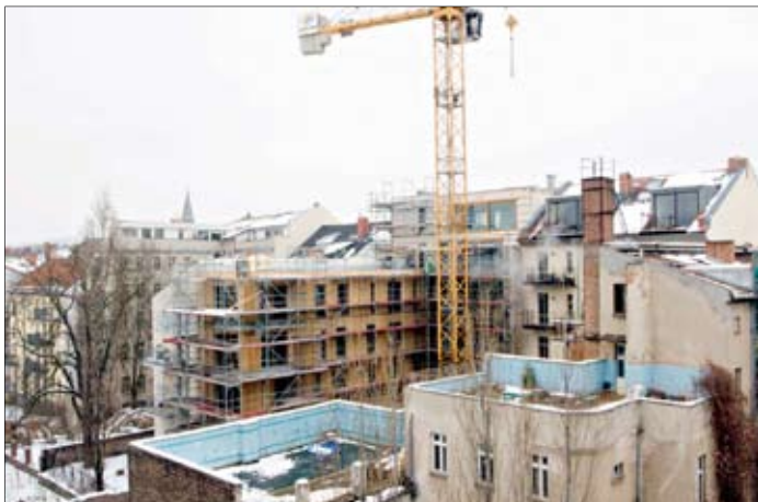
Das Haus Fehrbelliner Straße 90 mit seinem hofseitigen Gebäudetrakt soll Mitte des Jahres bezugsfertig sein.
