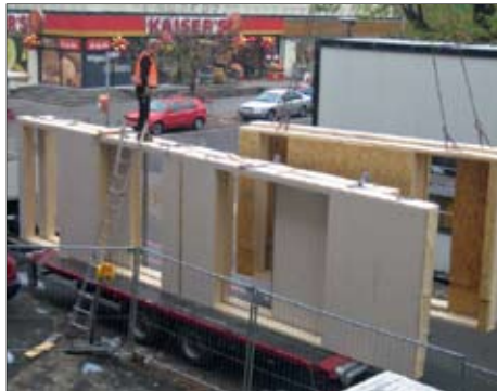
Anlieferung der Tafелеlemente, die von Holzbau Hunold im thüringischen Leinefelde vorgefertigt wurden.
